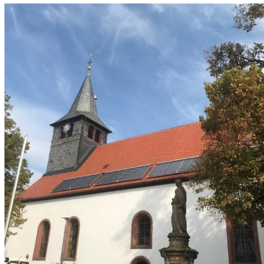
Solarthermie auf dem Kirchendach
