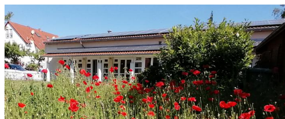
Gemeindehaus mit Photovoltaik-Anlage
