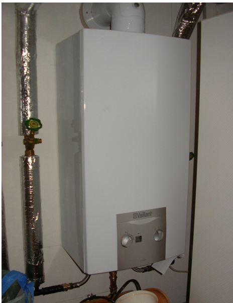
Gasbetriebener Durchlauferhitzer DBH, eingebaut 2010
